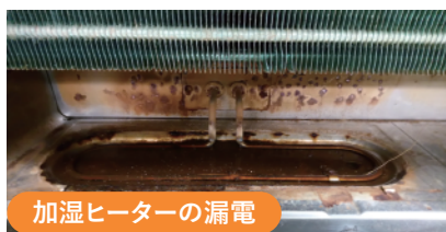
加湿ヒーターが汚れたまま使用を続ける事による漏電事例がございます。
